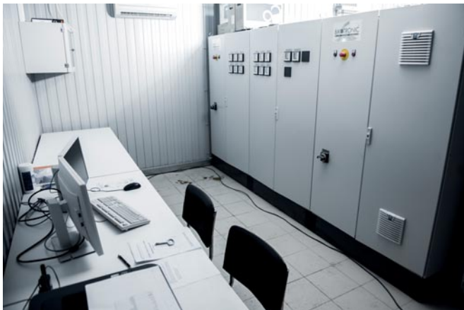
Blick in den Steuerungsraum
