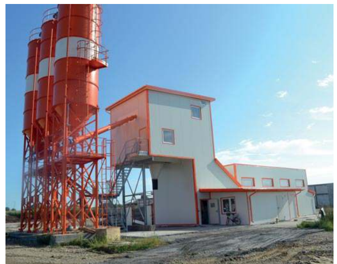
Die gesamte Verwiege- und Mischanlage wurde mit einer wetterfesten Verkleidung versehen
