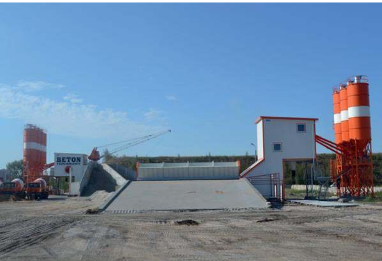
Die Reihensiloanlage verfügt über vier Gesteinskörnungssilos mit einem jeweiligen Kammervolumen von 35 m 3
