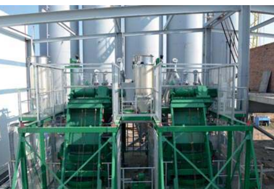
Die notwendige Mischanlage für das neue Werk lieferte Teka
