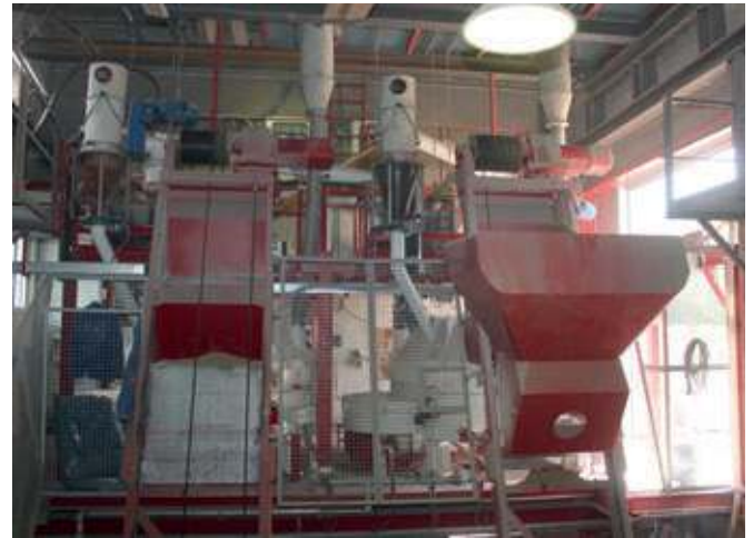
Die Beschickung der Betonmischer mit Gesteinskörnungen erfolgt über zwei Kübelaufzüge.
