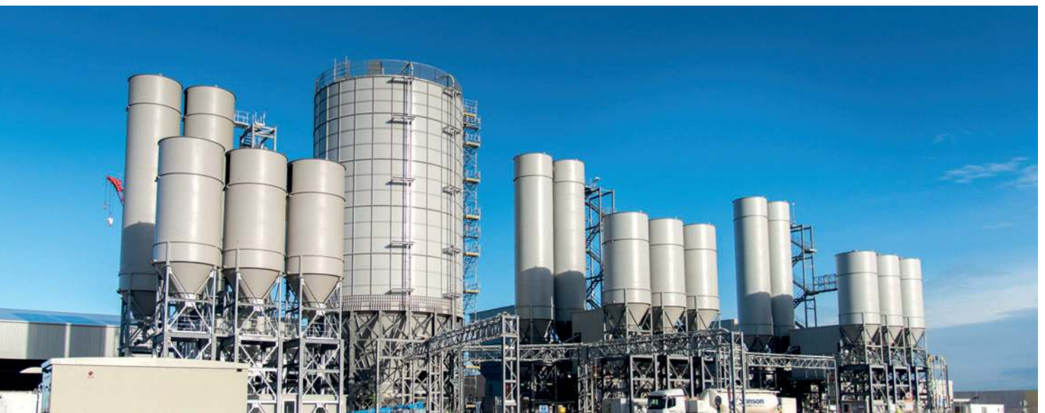
Ansicht der drei Betondosieranlagen von Bylor, mit Hüttensandmehl-Silos in Hinkley Point C (Dezember 2017) (Bild: EDF Energy 2017)
