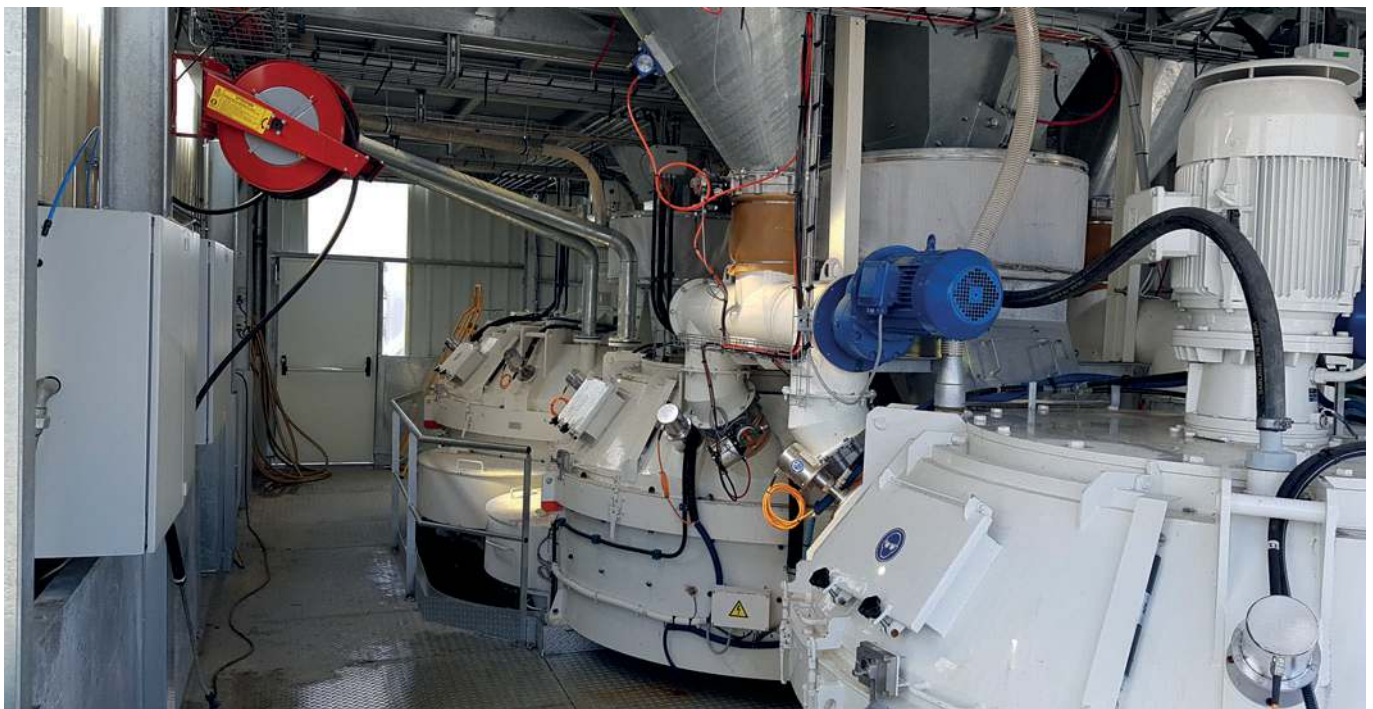
Die neue Mischanlage verfügt über 3 Teka-Mischer, die jeweils mit einem automatischen Hochdruckreinigungssystem ausgestattet sind.
